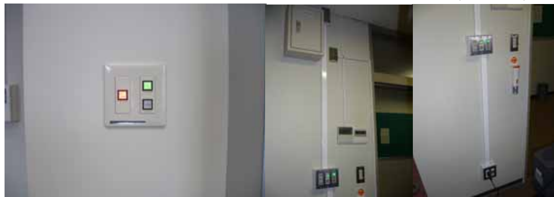
操作パネル(壁面露出BOXにて設置) 入力パネル(PC + ビデオ接続)
